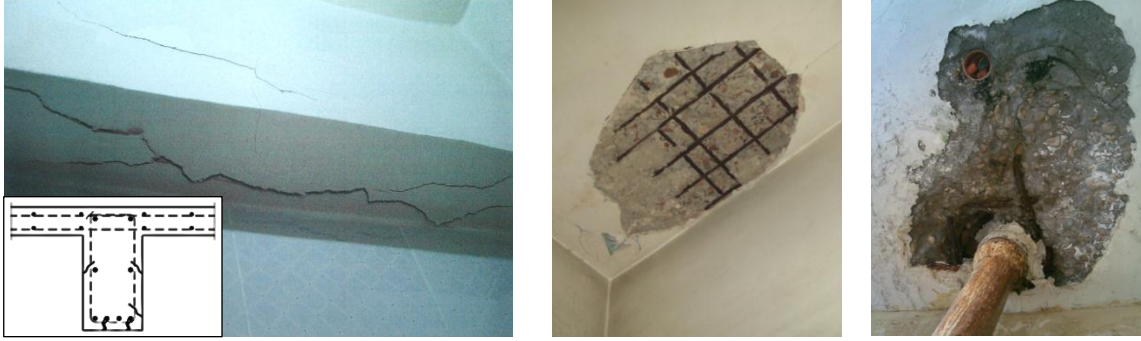
شكل (٧): تؤدي المياه المتسربة إلى صدأ حديد التسليح وتلف الغطاء الخرساني لحديد التسليح (الدراسة الميدانية)
