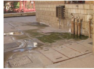
طفح مجاري بسبب انسداد مسارات الصرف
