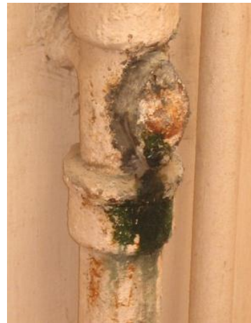
تسريب نتيجة استخدام أسمنت بدلا من استخدام جوانات وإحكام ربط الوصلات لطبة تسليك
