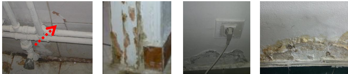
تضرر أعمال المحارة والدهانات قد تضرر بالأعمال الكهربائية إتلاف أعمال النجارة انتفاش الأرضيات والحوائط شكل (٦): تأثير مشاكل الأعمال الصحية على مواد وعناصر النهو داخل المباني (الدراسة الميدانية)
