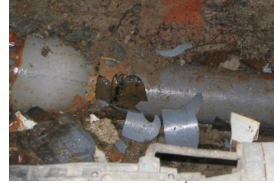
ماسورة صرف أفقية مكسورة تظهر عدم مناسبة السمك لقطر الماسورة
