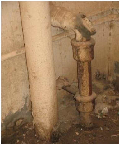
صدأ وتآكل المواسير الزهر بسبب تعرضها للمياه من الخارج وفي غياب الصيانة
