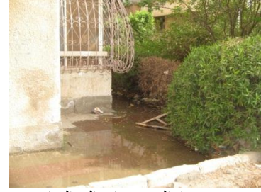
تسرب مياه المزروعات إلى المباني
